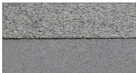
Figure 5.7 – Comparaison entre une surface en béton non traitée (en bas) et dénudée (en haut)
