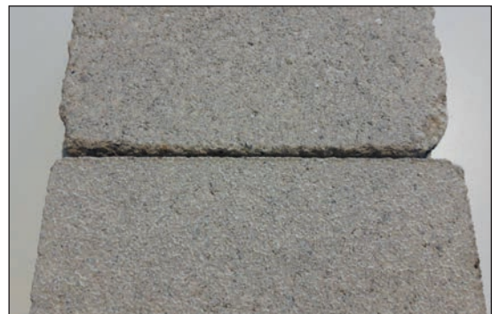
Figure 5.14 – Comparaison entre une surface en béton non traitée (en bas) et vieillie (en haut)
