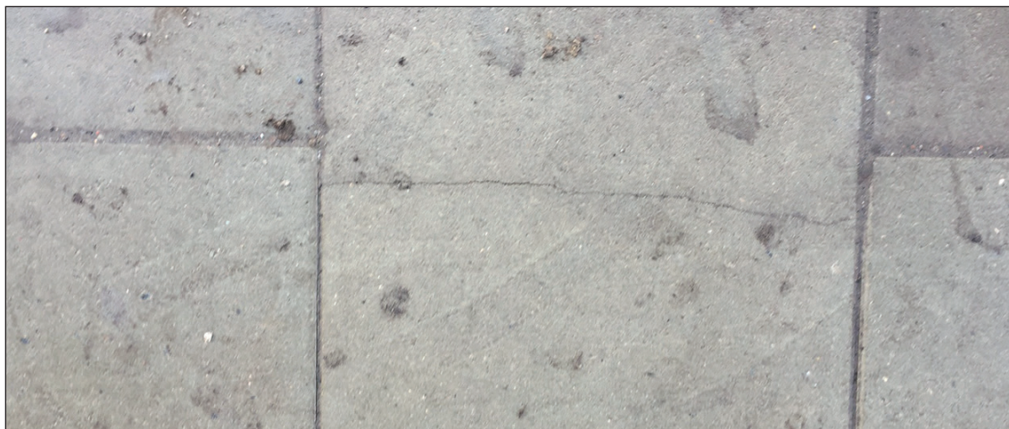
Figure 9.9 – Rupture constatée dans les dalles de la figure 9.8
