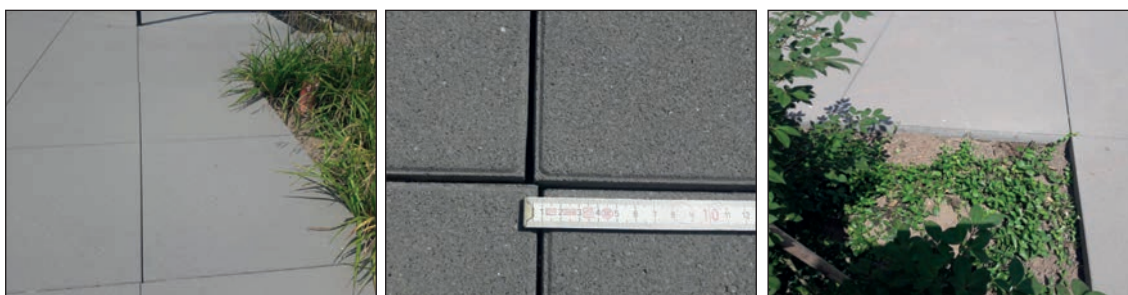
Figure 9.4 – Exemple de «dégradation esthétique» (glissement de joint) due à la dilatation thermique combinée à d'un contrebutage défectueux
