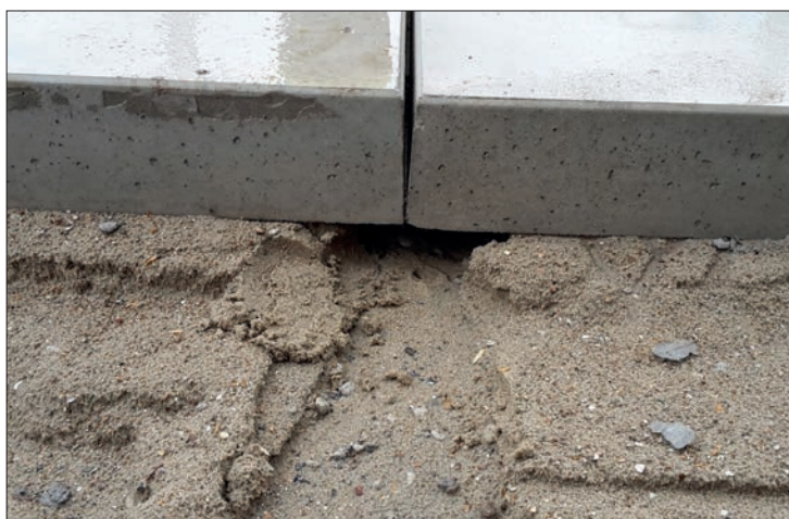
Figure 4.2 – Exemple de lessivage de la couche de pose dû à l'absence d'un contrebutage
