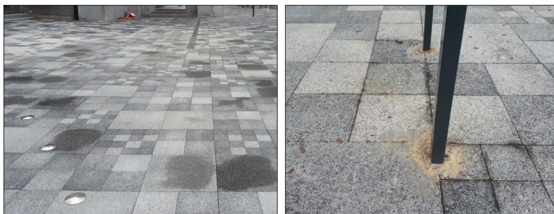
Figure 8.3 – Conception compatible avec la future gestion des mauvaises herbes grâce à des obstacles démontables et/ou une distance suffisante entre ceux-ci
