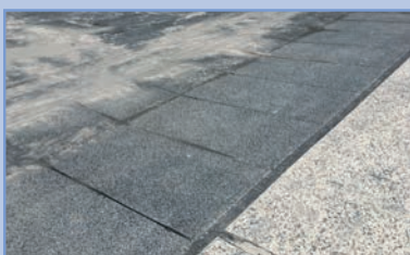
Dégradation due à l'effet de pompage
