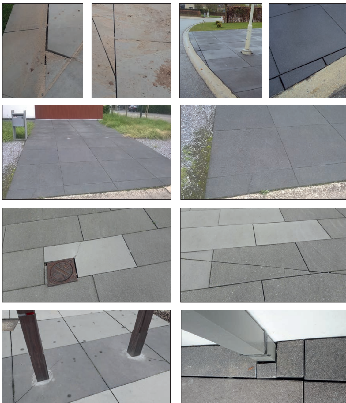
Figure 4.21 – Exemples de mauvaise exécution
